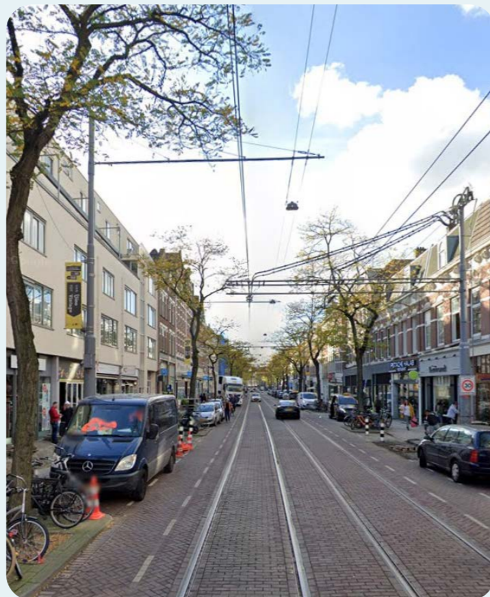
Elektriciteitsnetwerk trams en straatverlichting Rotterdam, Nederland
