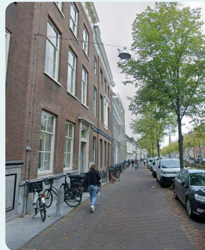
Straatverlichting met bedrading aan de gevel Delft, Nederland
