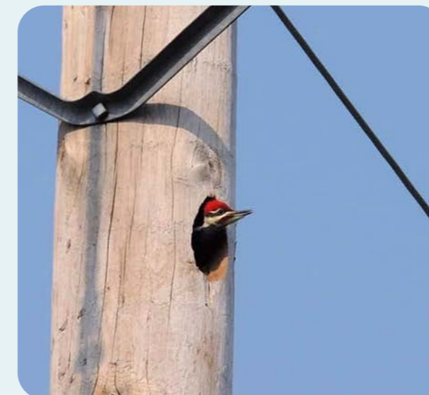
Een specht in een houten bovengrondse paal waaraan laagspanningskabels zijn bevestigd
